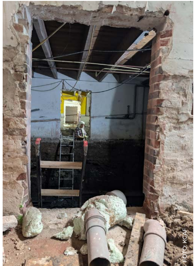
Funderingsherstel is ingrijpend en kostbaar. Bij grachtenpanden in de binnenstad is het lucratief om dat te combineren met een kelder voor extra woonruimte; bij standaard rijtjeswoningen is het een kostenpost.
