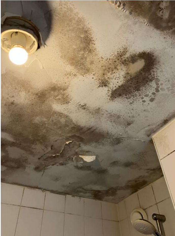
Schimmel op het plafond van de douche
