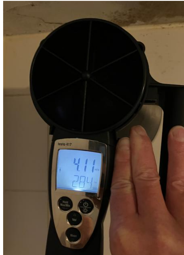
Debietmeting ventilatie in de badkamer 28,4 dm 3 /s
