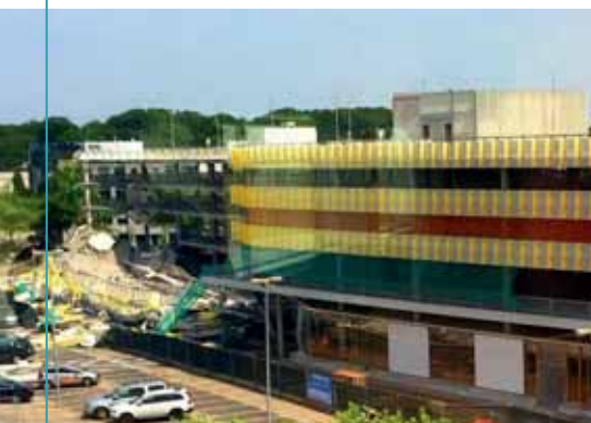
De deels ingestorte parkeergarage bij Eindhoven Airport. Foto: Gemeente Eindhoven / Rijksoverheid.nl.
