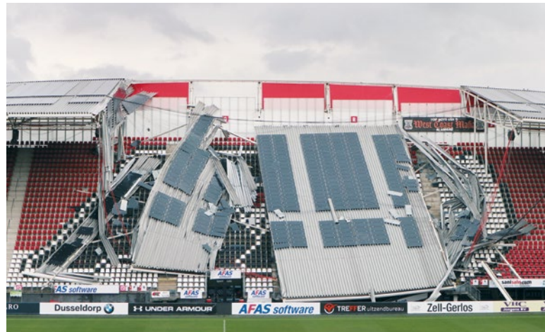
De instorting van een deel van het dak van het AZ-stadion was aanleiding voor de ontwikkeling van NTA 8790.
