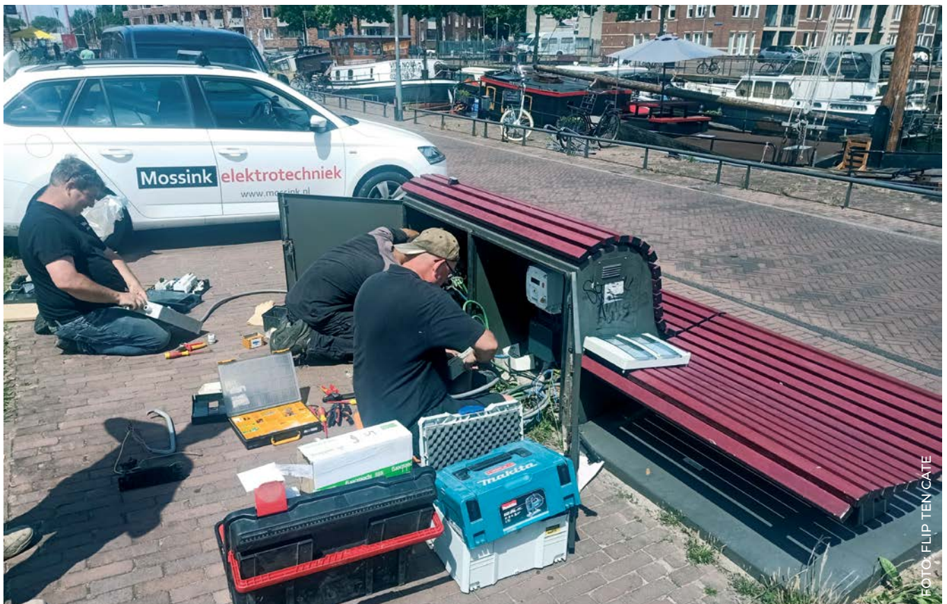
Geïntegreerd elektriciteitskastje in zitbank langs de Eem.
