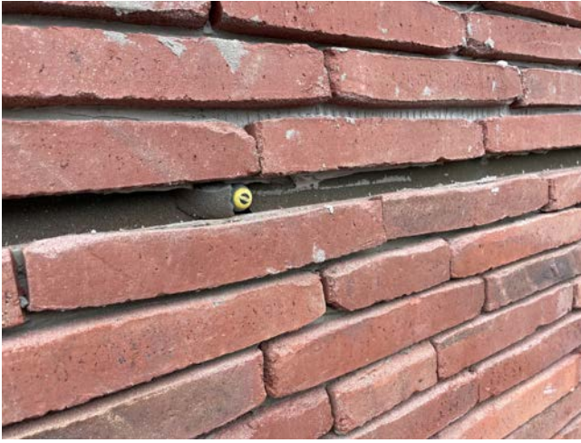
De voegen tussen de elementen zijn afgedicht met band. Het band heeft onvoldoende compressie en is niet stuikend aangebracht.
