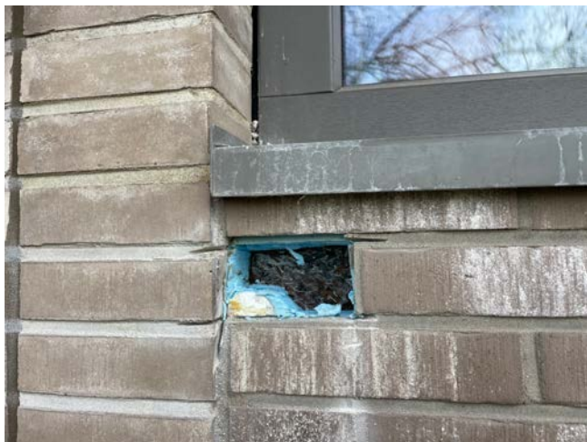
HSB afgewerkt met houtvezelplaat. De houtvezelplaat is aangetast door houtrot.
